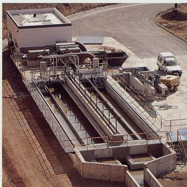
Imágenes de la estación depuradora de Toledo, que dará servicio a unos 60.000 habitantes, siendo las características del agua residual netamente urbanas Fotos: J. M. Moreno
