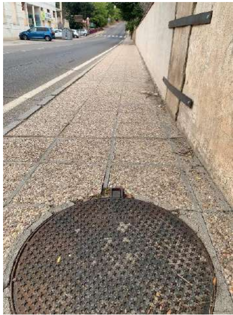
Registro de saneamiento en la acera de la Carretera de Navalpino
