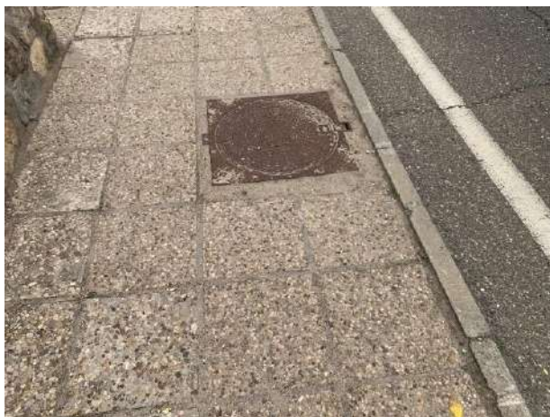
Registro de saneamiento en la acera de la Carretera de Navalpino
