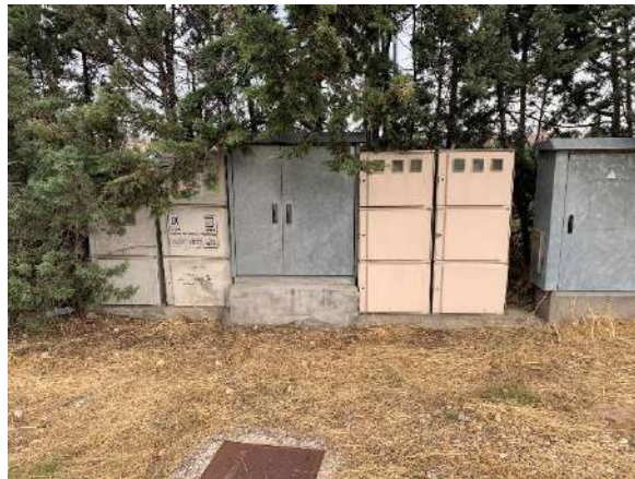
Armarios de cuadros eléctricos junto al muro de cerramiento oeste.
