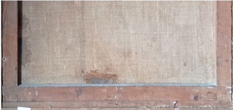
Acumulación de suciedad y manchas
