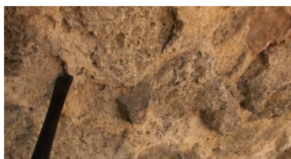
Deplacaciones en el intrados de los arcos debidas a sales y/o heladas
