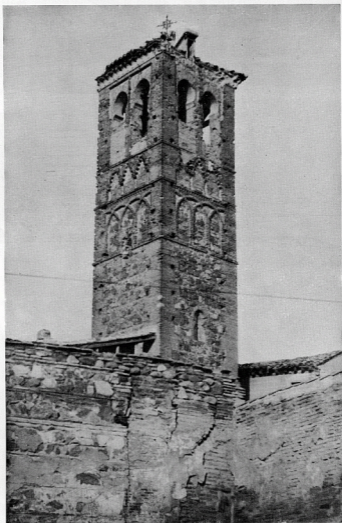
Estado de la torre de la Iglesia de San Miguel, en diciembre de 1951, antes de iniciarse las obras de reconstrucción.
